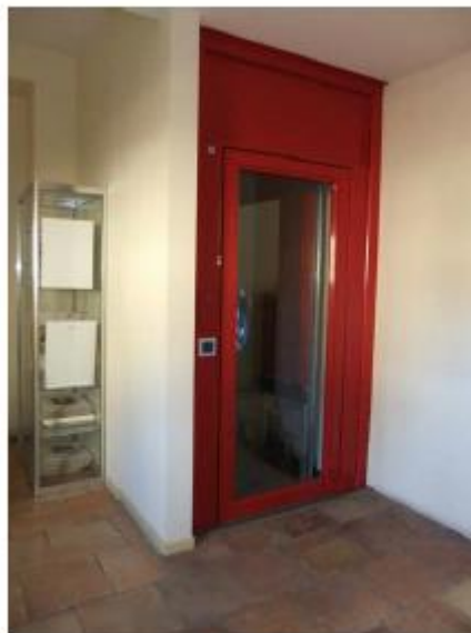
Ascenseur de l'aile Sud donnant accès à l'ensemble du 1er étage visité
